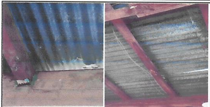
2. Sustitución de soporte de madera a estructura de metal para posteriormente techar y cambio de lamina.
